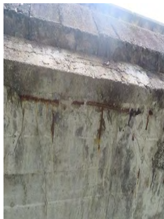
图 13 4-2#桥面板砼局部锈胀露筋面积 2.8m 2
