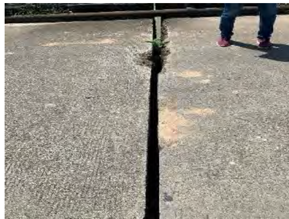
图 28 2#桥墩处接缝破损
