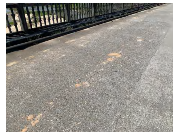
图 24 1#跨桥面混凝土露骨面积 0.08m 2
