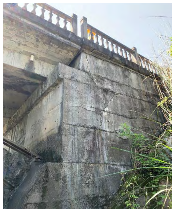
图 20 5#台前墙距竖向裂缝长 3m, 宽 18mm
