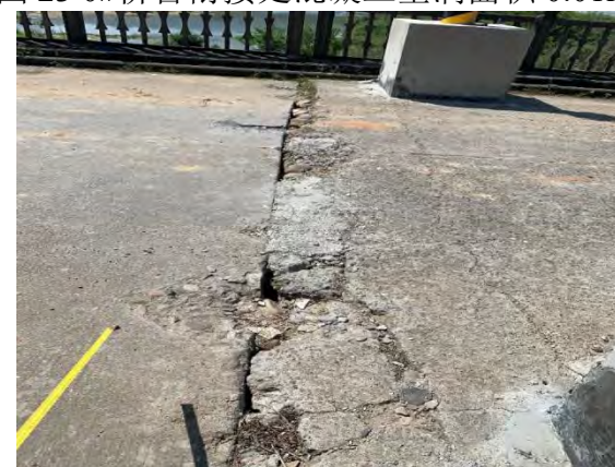
图 25 0#桥台衔接处不均匀沉降, 混凝土缺失, 压坏
