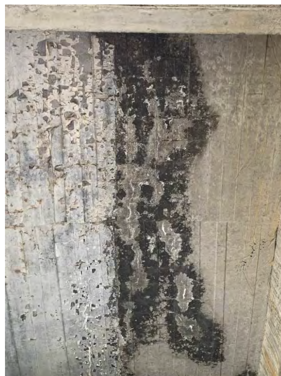
图 12 0#桥台至 1#墩第一块桥面板腐蚀严重面积 0.36m 2
