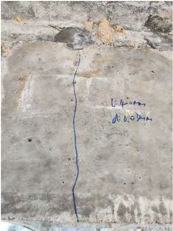
图 8 1-2#拱片和 1-3 拱片横系梁 U 型裂缝 长 0.4m，宽 0.03mm
