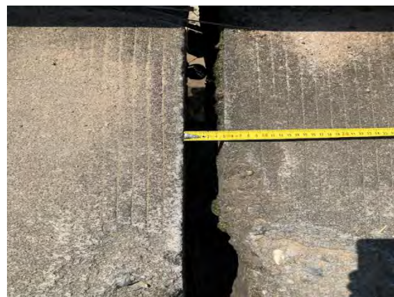
图 27 1#桥墩连接缝过宽，且上游侧破损，露筋 (2)栏杆、护栏检测现场图片
