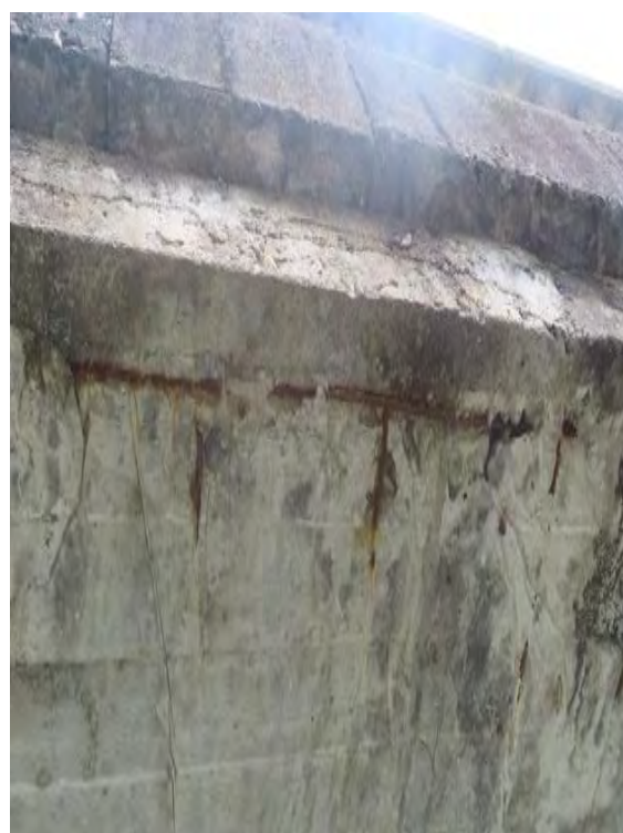
图 13 4-2#桥面板砼局部锈胀露筋面积 2.8m 2
