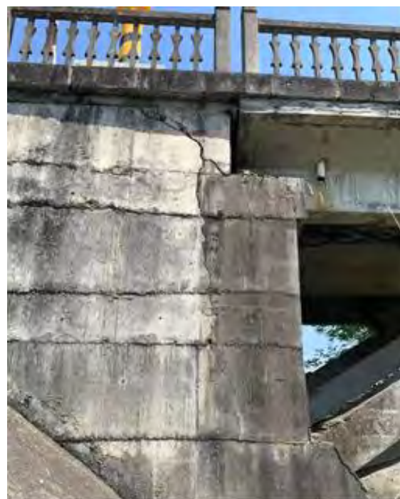
图 19 0#桥台上游侧出现斜裂缝长 2.6m, 宽 10mm
