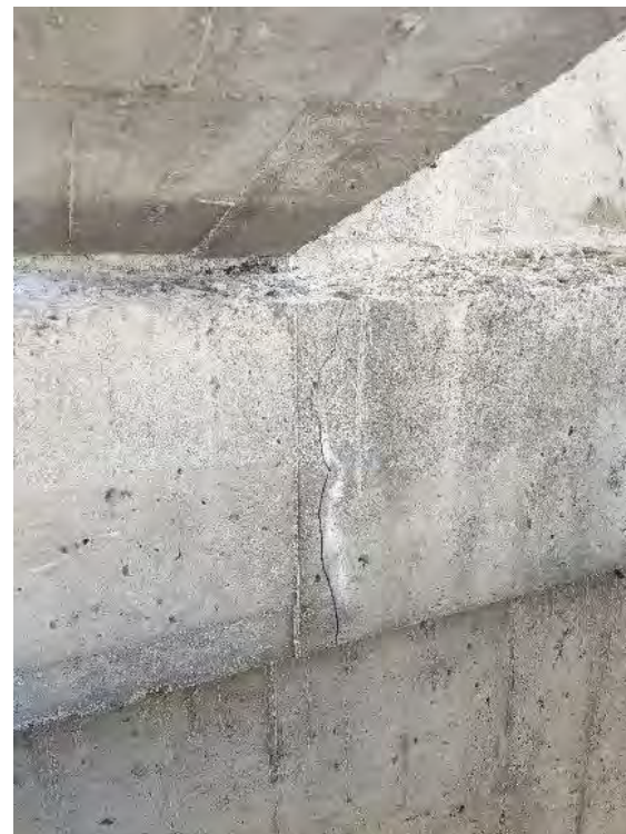
图 18 2#墩承台处竖向裂缝长 400mm, 宽 0.03mm
