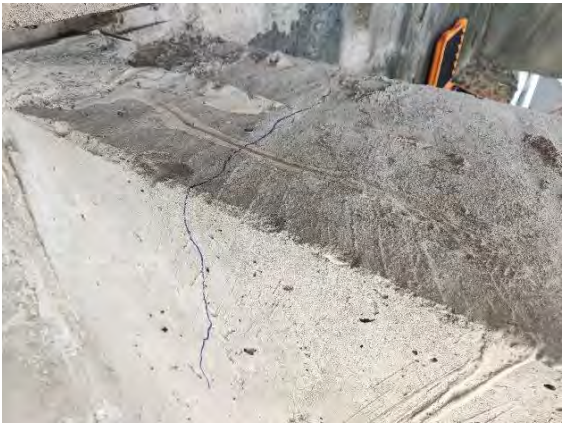
图 3 1-2#拱片大桩号主拱腿 U 型裂缝长 0.6m,宽 0.02mm
