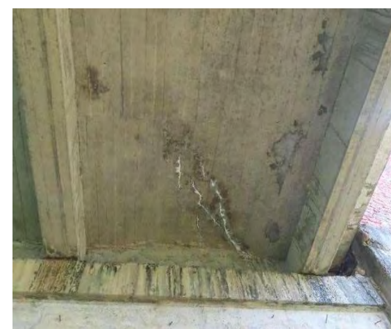
图 14 1-3#桥面板斜缝长 2.8m，宽 0.04mm 下部结构
