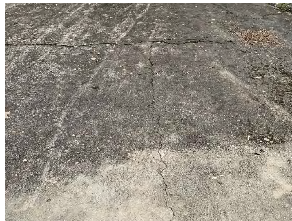
图 16 0#桥台下游侧锥型坡竖向裂缝长 2m，宽 3mm
