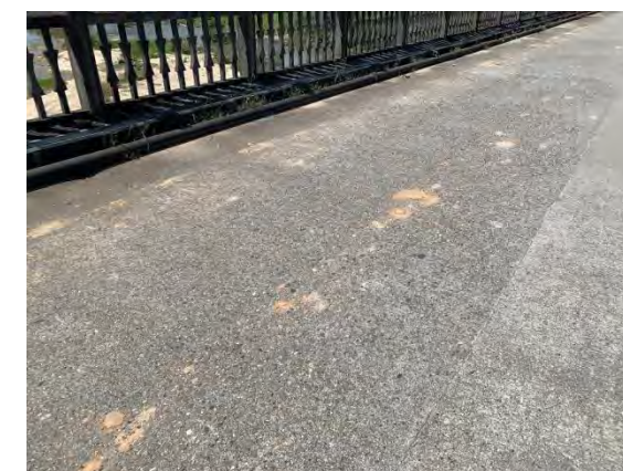
图 24 1#跨桥面混凝土露骨面积 0.08m 2
