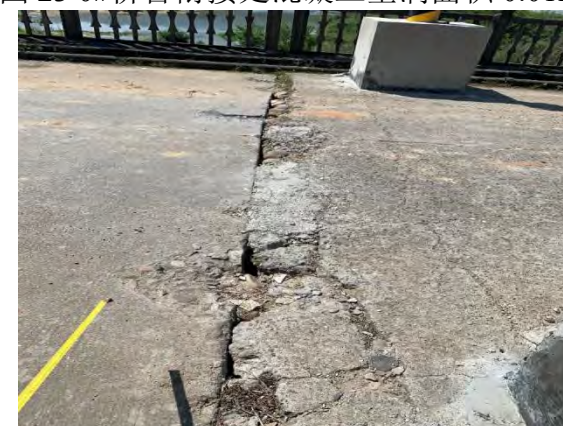
图 25 0#桥台衔接处不均匀沉降, 混凝土缺失, 压坏
