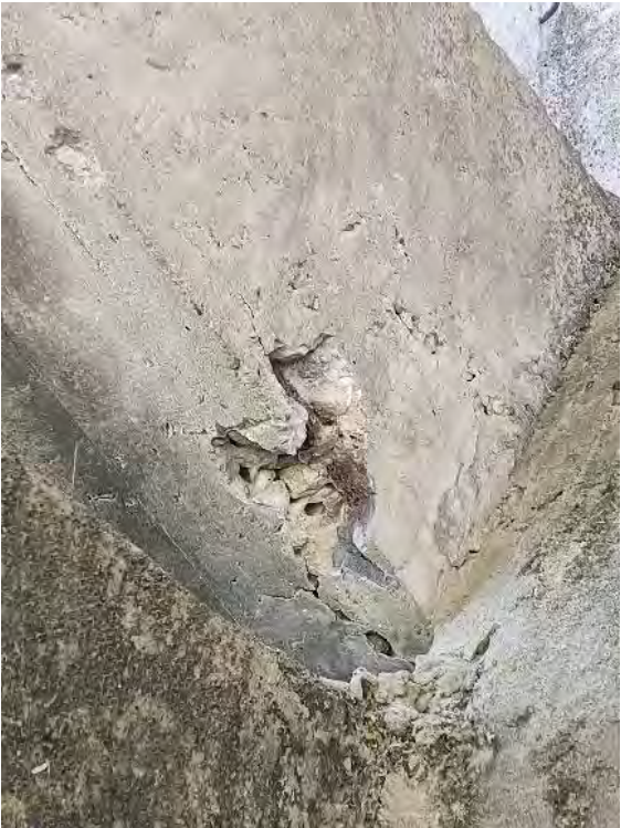
图 7 2-3#拱片大桩号侧主拱腿拱座连接处有 露筋，锈蚀面积 0.12m²
