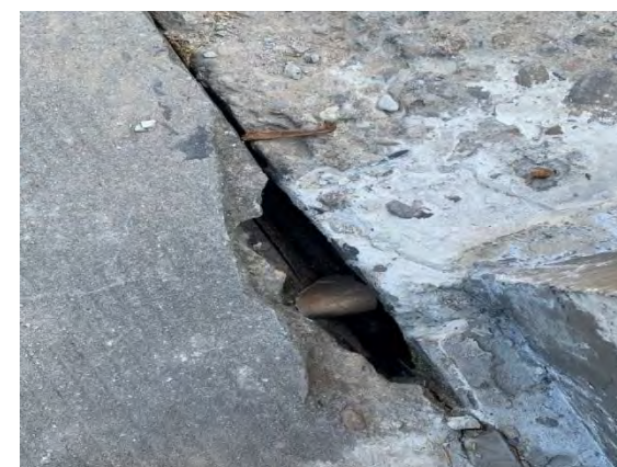
图 23 0#桥台衔接处混凝土空洞面积 0.01m 2
