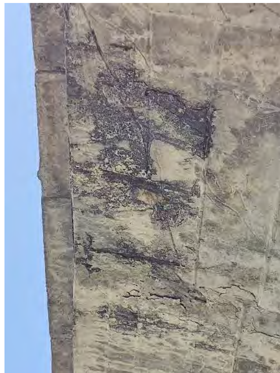
图 11 3-3#主拱翼缘板钢筋锈蚀，漏筋，锈胀面积 0.14m 2
