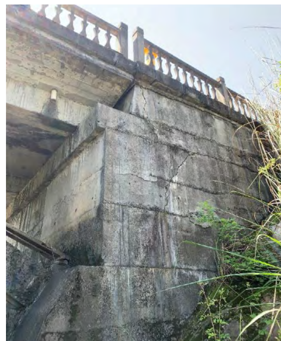
图 20 5#台前墙距竖向裂缝长 3m, 宽 18mm
