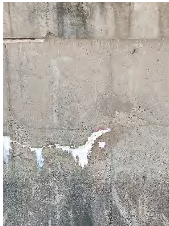
图 17 4#墩开裂, 渗水, 泛白长 1.5m, 宽 2mm
