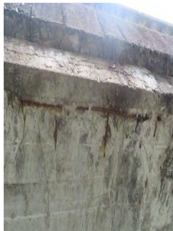
图 13 4-2#桥面板砼局部锈胀露筋面积 2.8m 2
