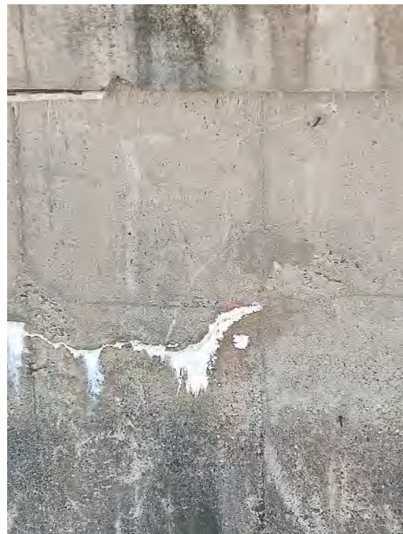
图 17 4#墩开裂, 渗水, 泛白长 1.5m, 宽 2mm
