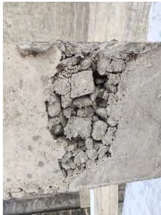
图 10 3-2#与 3-3#拱片之间横系梁混凝土不密实处面积 0.2m 2
