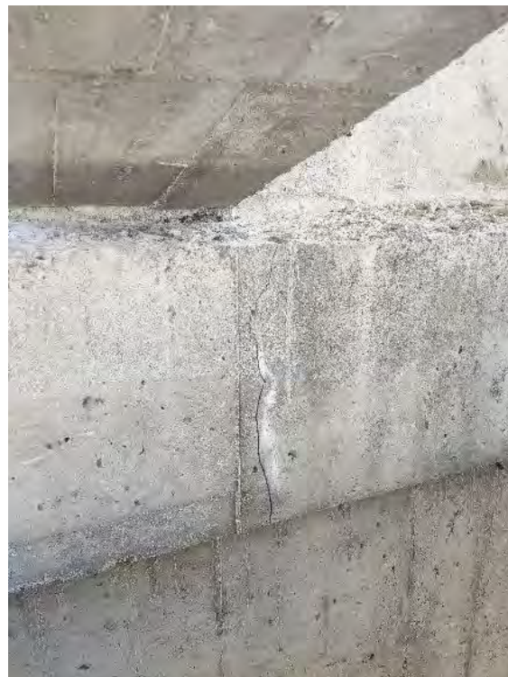
图 18 2#墩承台处竖向裂缝长 400mm, 宽 0.03mm
