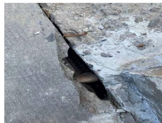
图 23 0#桥台衔接处混凝土空洞面积 0.01m²
