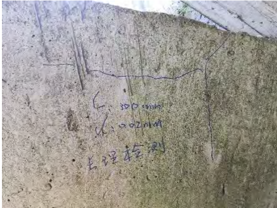
图 2 1-1#拱片大桩号侧主拱腿主拱腿上游侧 距离承台 1.45 米处裂缝长 0.3m,0.02mm
