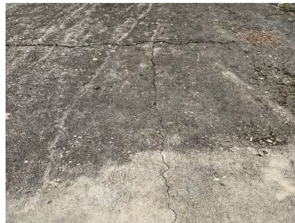
图 16 0#桥台下游侧锥型坡竖向裂缝长 2m，宽 3mm (2) 桥墩检测现场图片
